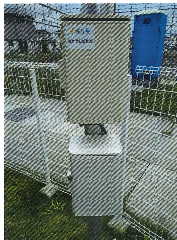
■ 設置した充電設備
